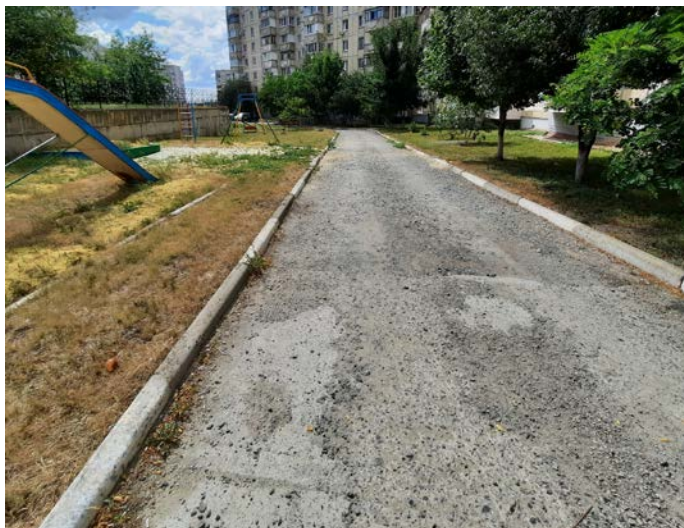
Дорожное покрытие подлежит замене
